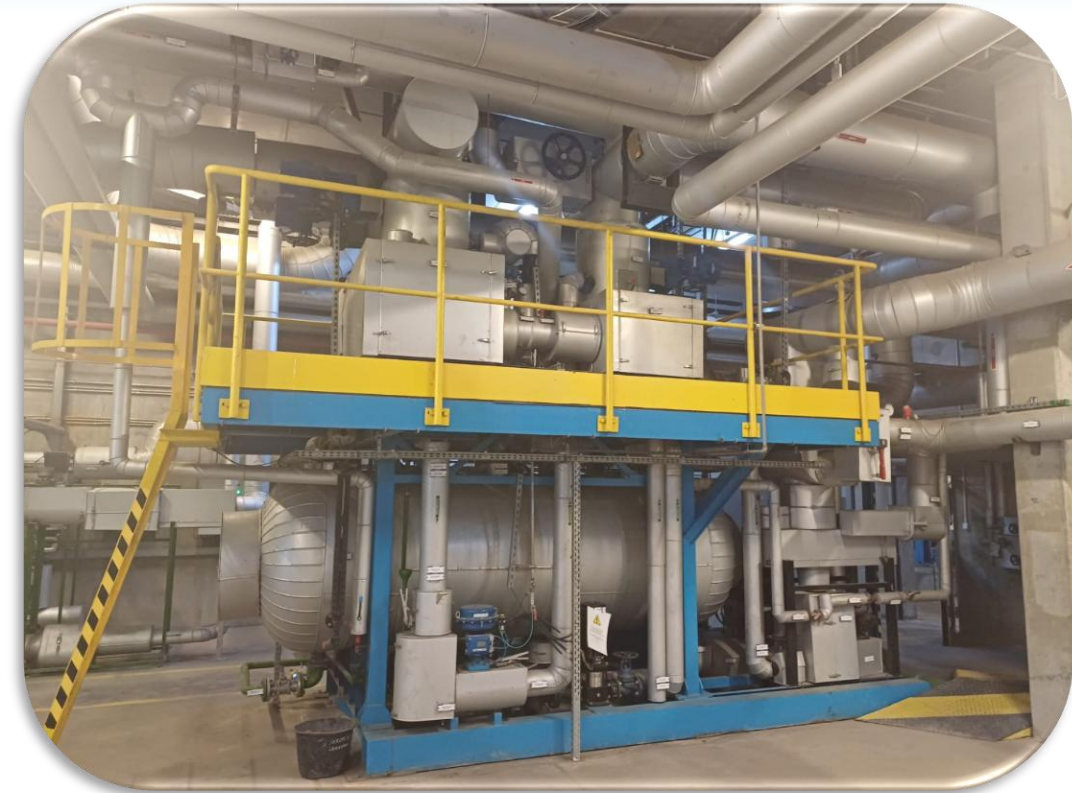
Wymiennik ciepłowniczy sieci miejskiej District heating exchanger of the municipal network
