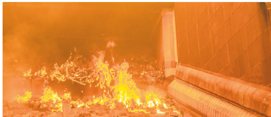
■ W błędzie jest ten, kto myśli, że termiczne unieszkodliwianie odpadów szkodzi. Palenisko rusztowe, na którym spalane są odpady
