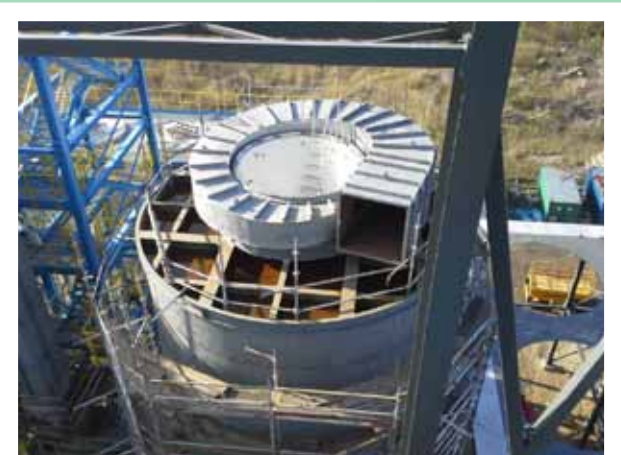
Węzeł oczyszczania spalin – widok na absorber i rozdzielacz gazu (foto – Marcin Galan)
