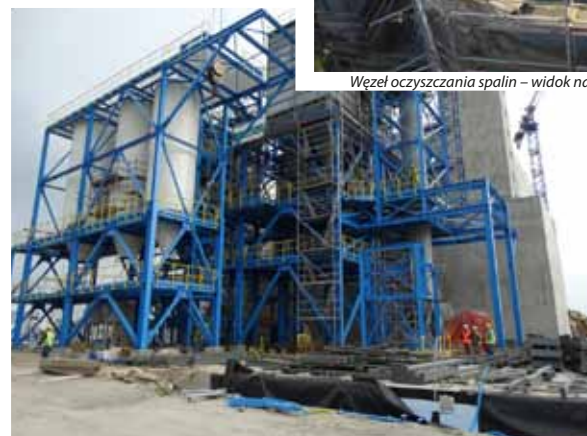
Węzeł oczyszczania spalin – widok na silosy, filtry i kanały spalin. (Fot. Marcin Galan)
