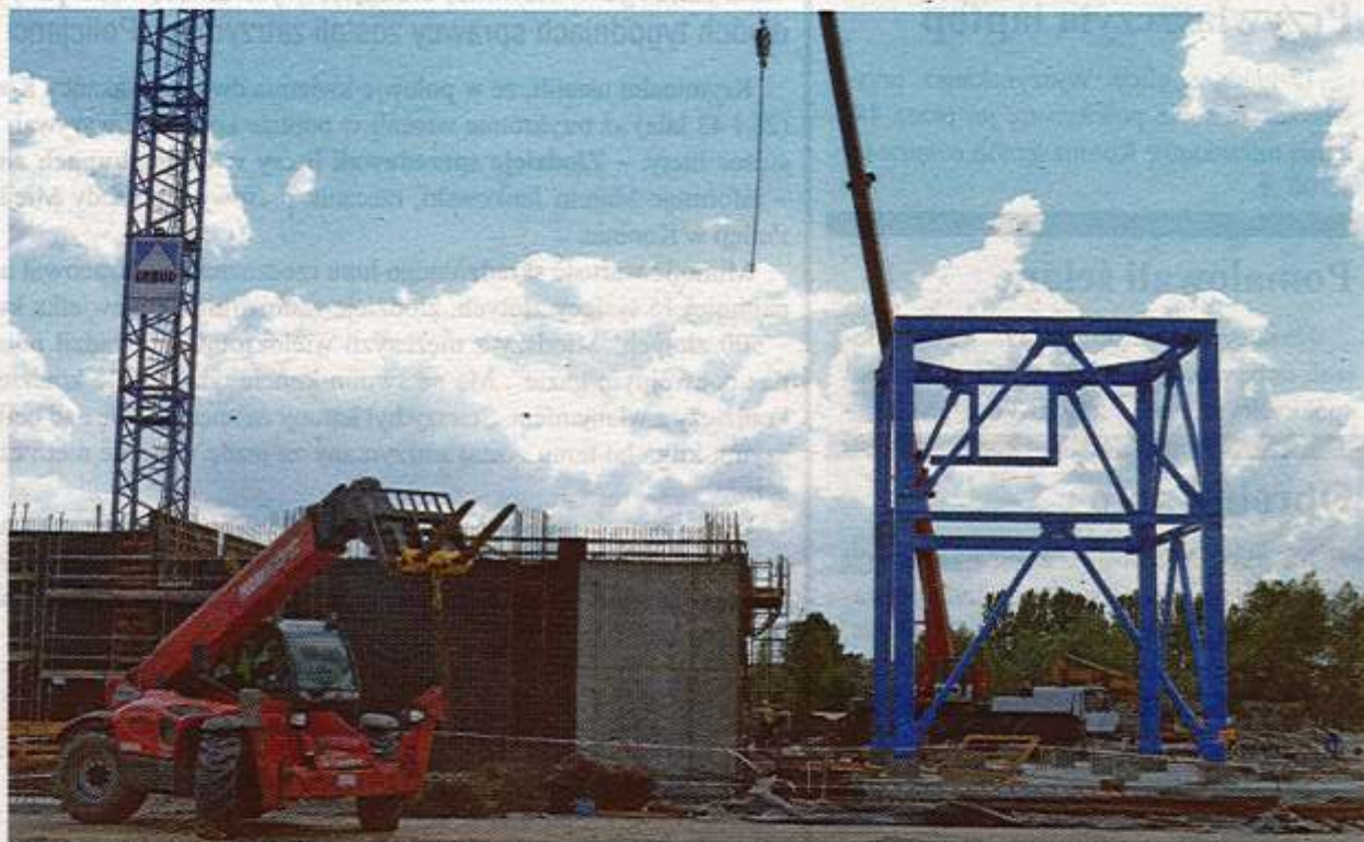
9 maja mieszkańcy będą mogli zobaczyć na własne oczy, jak postępują prace przy budowie spalarni
